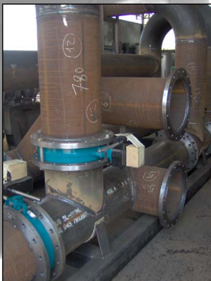
Dettaglio Skid DN400. Skid DN400 Detail.
