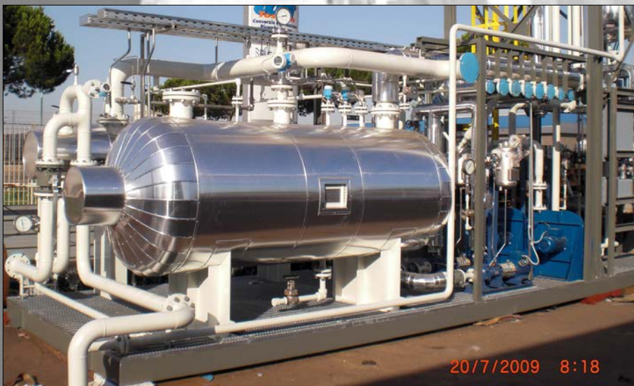
Skid per impianto petrolchimico; Skid for petrochemical plant.
