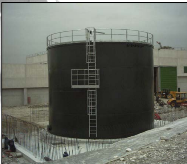
Cisterna per petrolio Ø10.000xHf 8.000 Tank for oil Ø 10.000xHf 8.000
