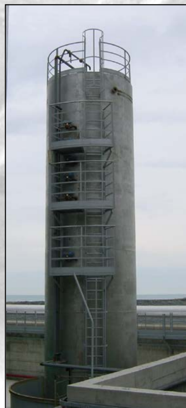
Cisterna per separazione olio – acqua. Tank for separation oil – water.
